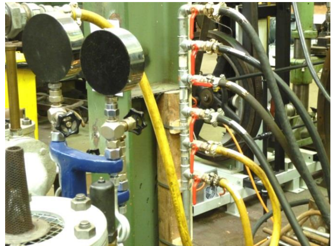
Verteilzentrale für die Druckluftversorgung
